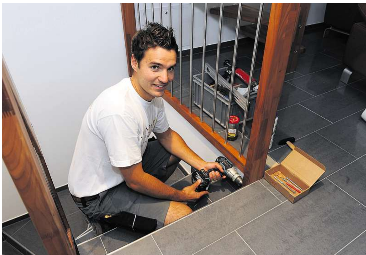
Ungewohnter Auftrag, professionell ausgeführt: Der Zimmermann Fabian Dubach montiert in einer Wohnung in Chur ein Treppengeländer. (FOTO THEO GSTÖHL)
