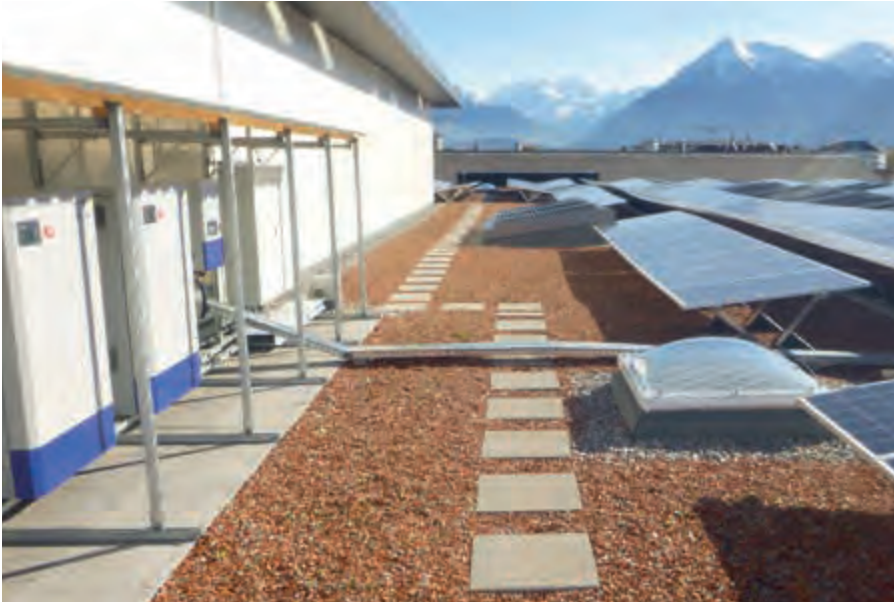
Abbildung 8: Kabelführung PV-Anlage zu Wechselrichter, Quelle: contec
