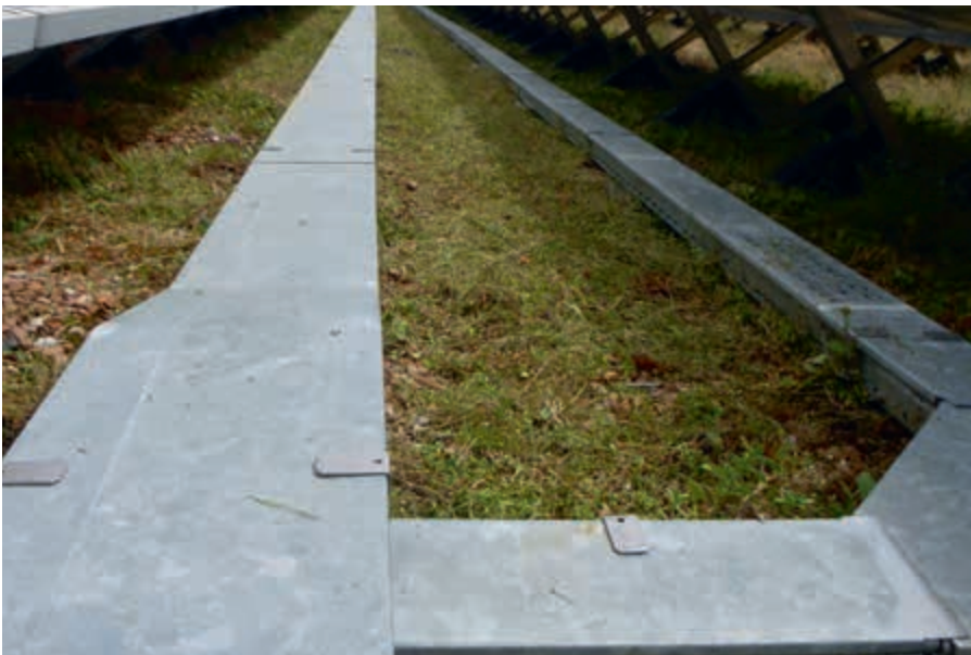
Abbildung 9: Kabelführung zwischen den PV-Modulen, Quelle: contec
